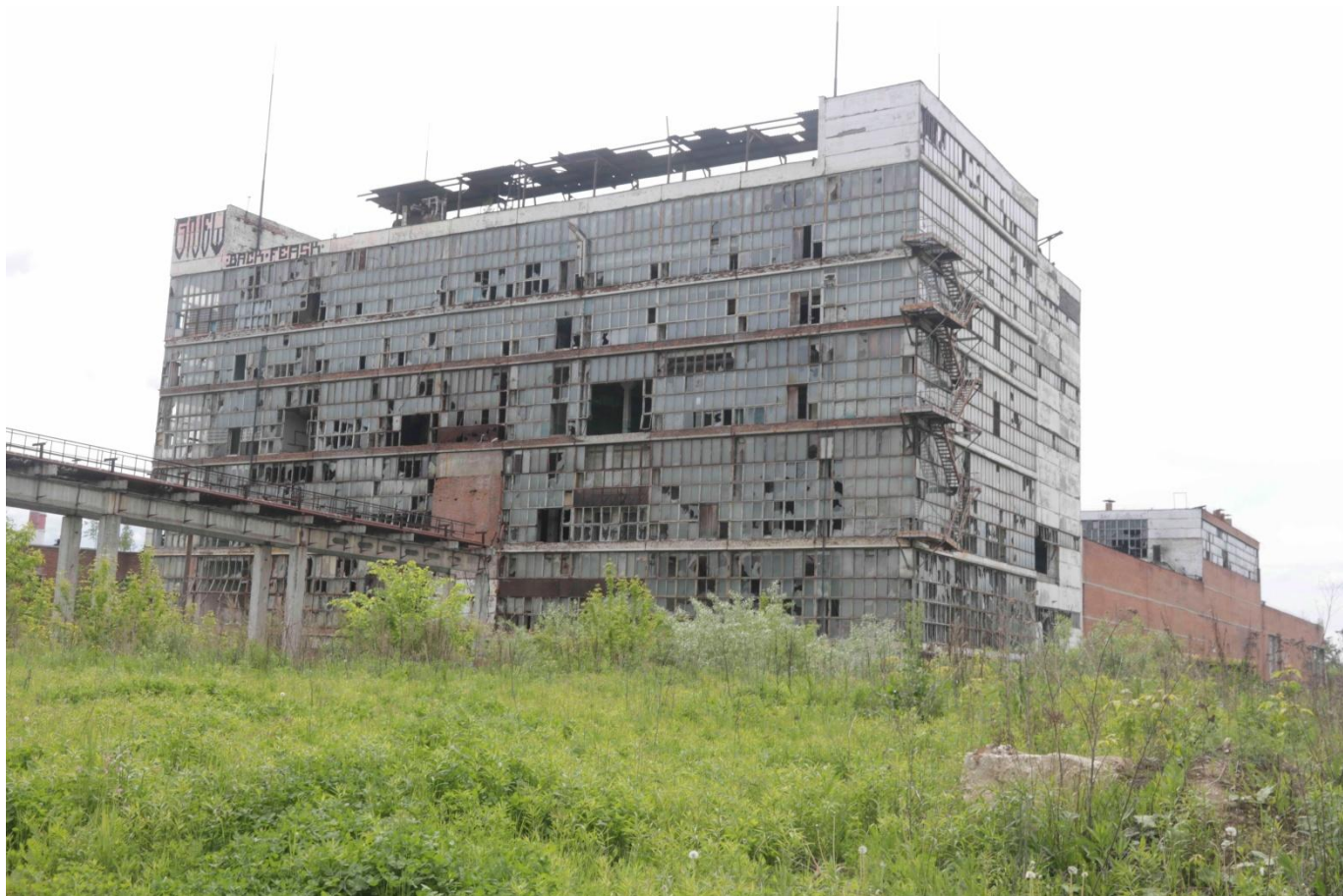
Фото: Владимир. Разрушенный корпус химического завода
